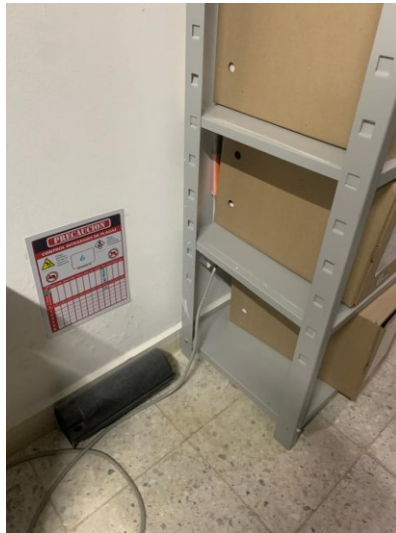
Ilustración 15 Detalle de los estantes metálicos - Fuente propia
