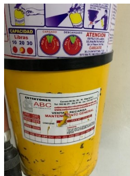
Ilustración 17 Detalle de extintor instalado en archivo central evidencia de encontrarse cargado – Fuente propia.
