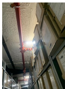
Ilustración 18 Detalle del sistema contra incendios- Fuente propia
